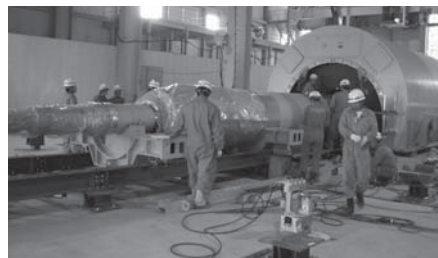
定期点検における機器の整備
