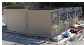
ガスタービン発電機 (海拔40m高台)
