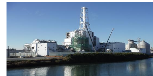
鈴川エネルギーセンターが建設中の石炭火力発電所の様子
