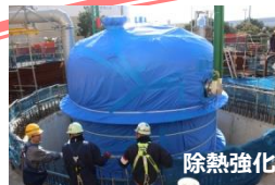
フィルタバント設備
