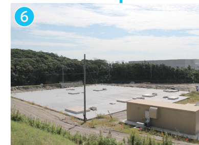
緊急時淡水貯槽
