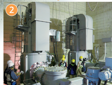
緊急時海水取水設備
