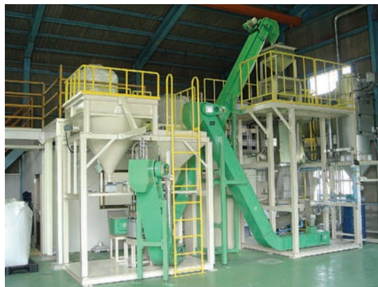
フロン類破壊処理装置
