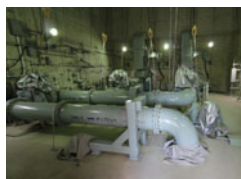
緊急時海水取水設備
