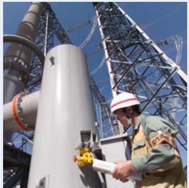
定期的な点検により変電設備の適正作動を確認
