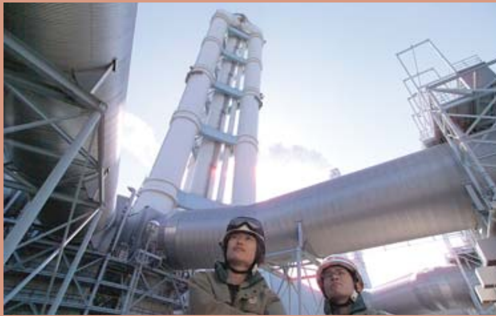
川越火力発電所の設備点検。先進の技術と人の力で電力の安定供給を支えています。
