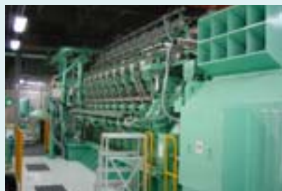
コージェネレーション設備
