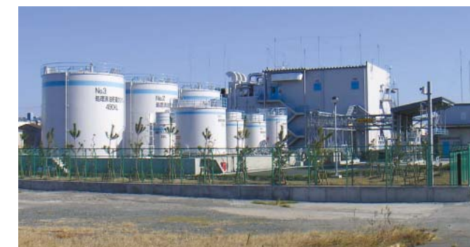
絶縁油リサイクルセンター
