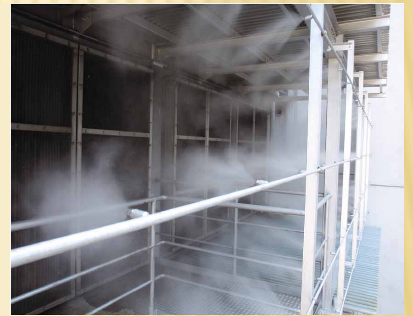
出典：中部電力 新名古屋火力発電所
