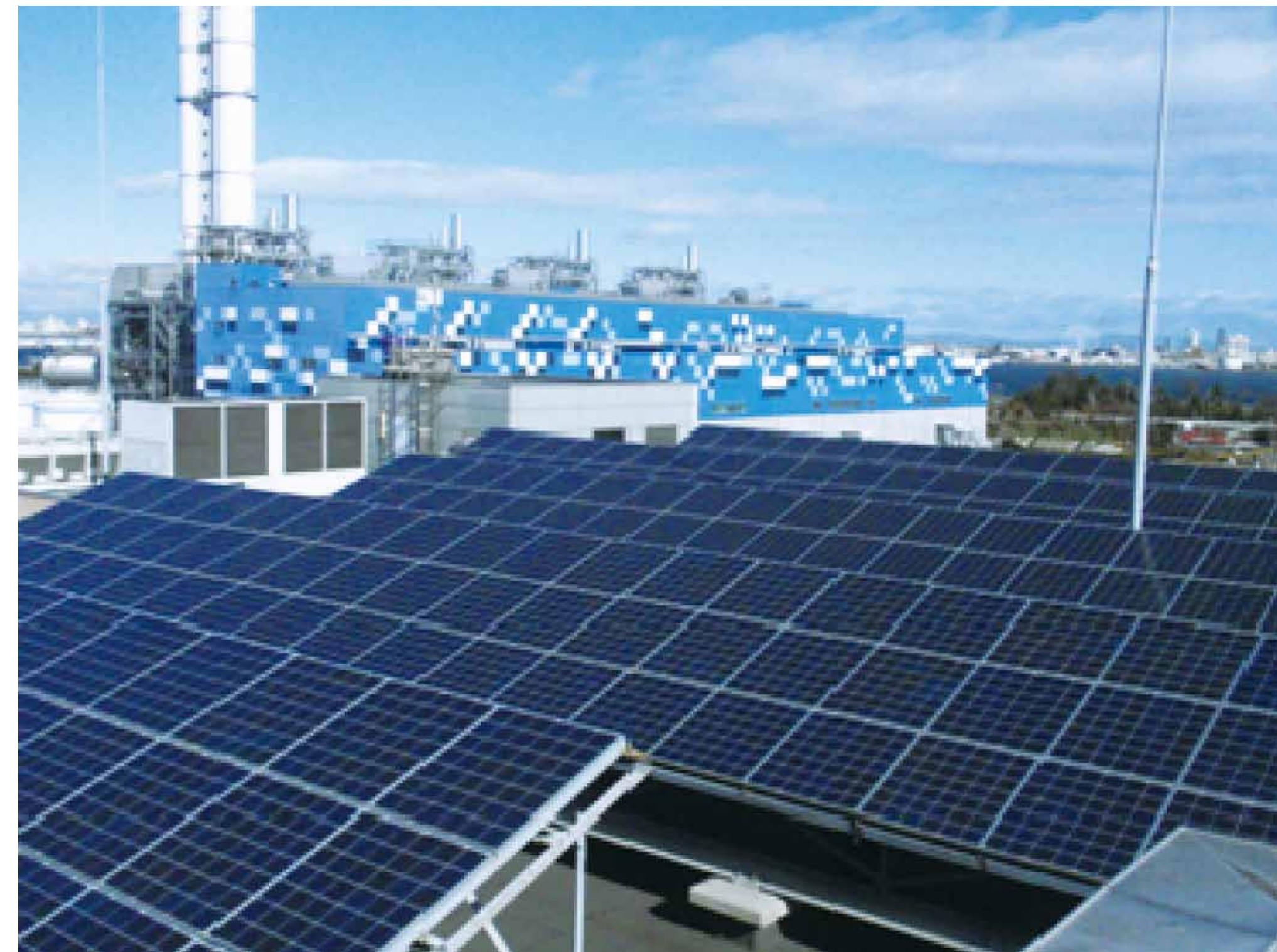
新名古屋火力発電所 40(kW) 屋上設置としては、最大容量 設置角度 標準的30度
