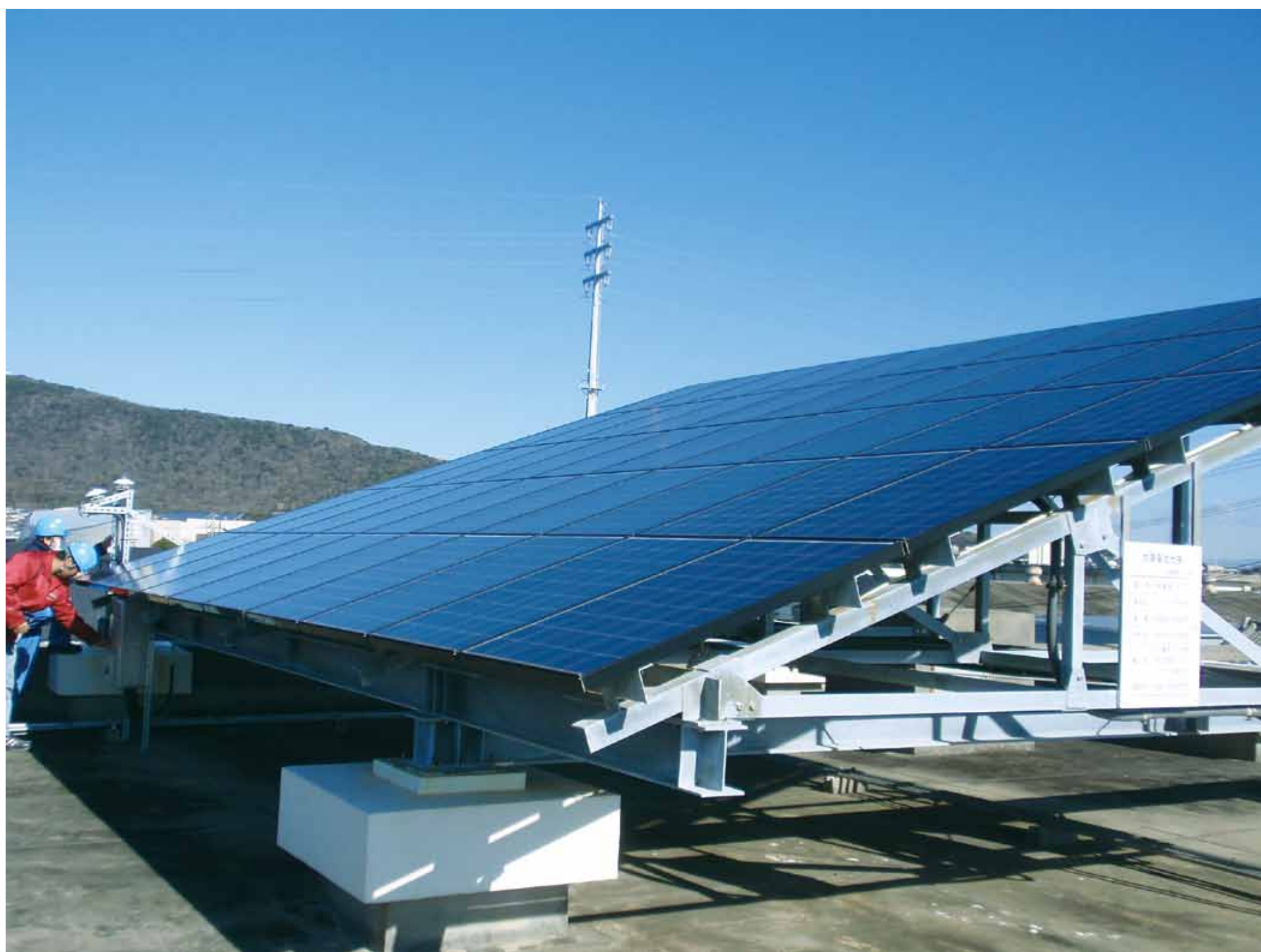
田原サービスステーション 6(kW) 強風に備えて低角度(20度)、架台強度大
