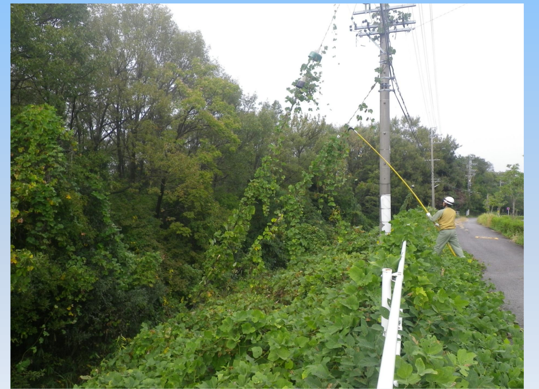
電柱の支線に巻きついたツル植物(クズ)
