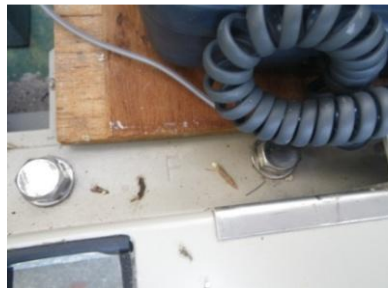
通信設備内で確認された糞
