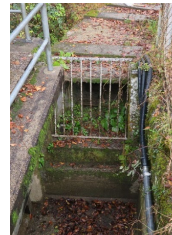
小規模水路の取水口の例
