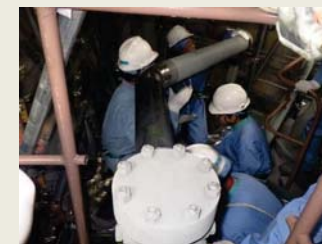
補給水系などの注水配管の追設点検の様子 [写真：4号原子炉建屋（放射線管理区域）]
