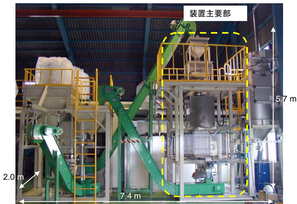
図2 ハロン分解処理装置の外観
