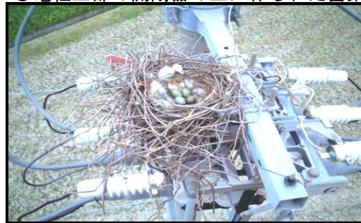
○電柱上部の開閉器の上に作られた営巣
