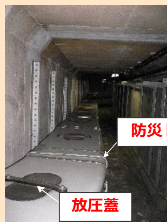
【ケーブル部】 防災トラフに収納
