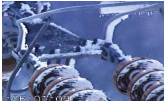
No.72鉄塔 上越火力(発)側がいし
