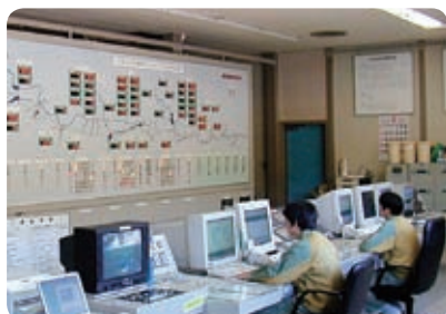
塩郷ダム管理所のダム監視状況
