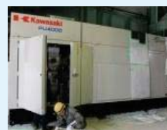
建屋内の発電機
