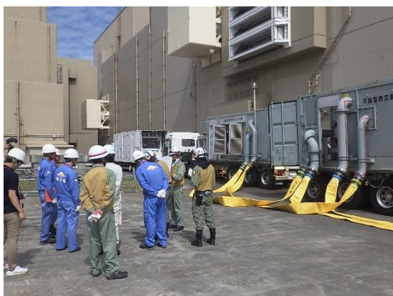
代替熱交換器用配管設置工事及び可搬設備の確保（代替熱交換器車） 点検の様子
