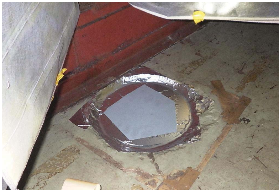
NRW- I 2 階 換気系主排気ユニット内
