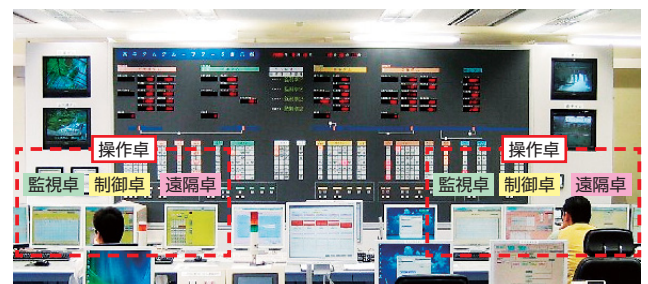
第4図 第三代ダム制御システム (西平土木管理所)
