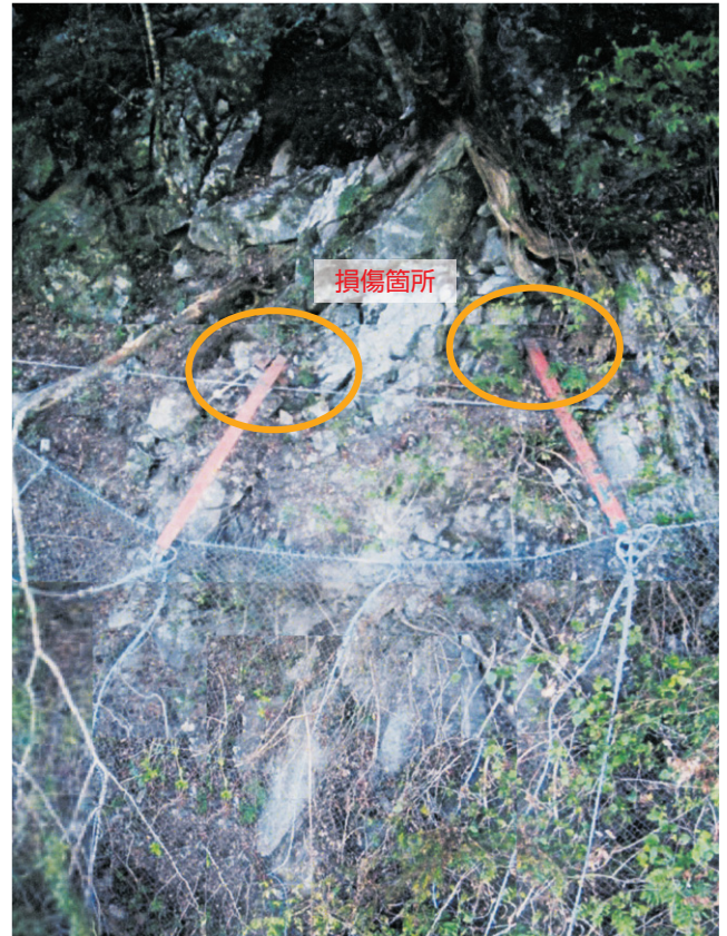
第5図 設備損傷状況
