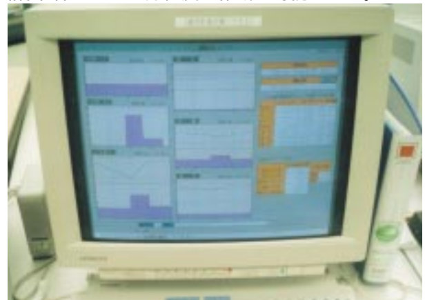
写真-1 システム外観(運転カーブ)
