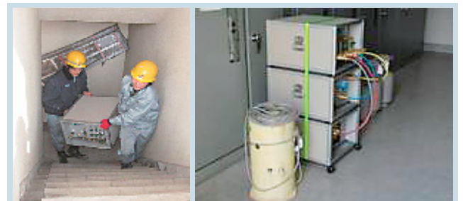
C変電所(長い階段での運搬も容易)
