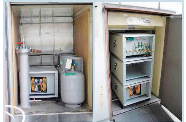
D変電所(荷物用エレベータにも積載可能)
