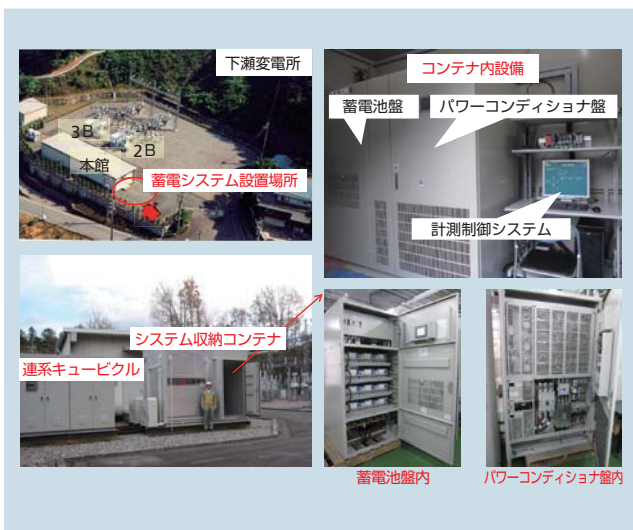
第3図 蓄電システム設置状況
