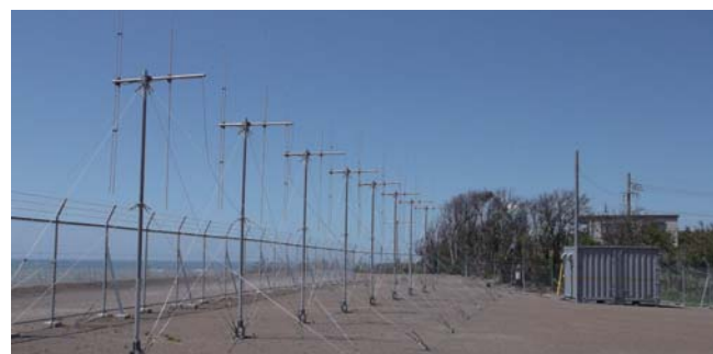
写真1 VHF帯のレーダーの外観
