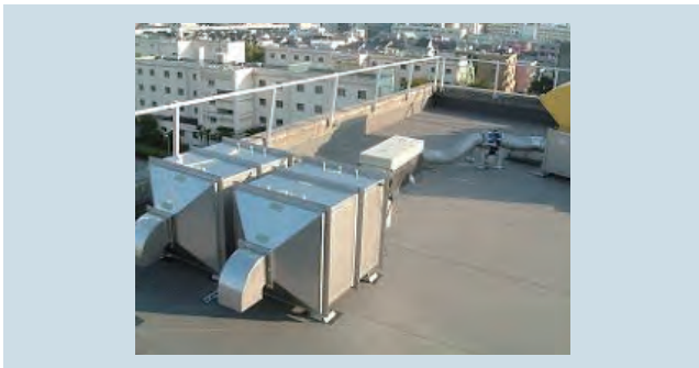
第3図 フィールド検証機設置の様子
