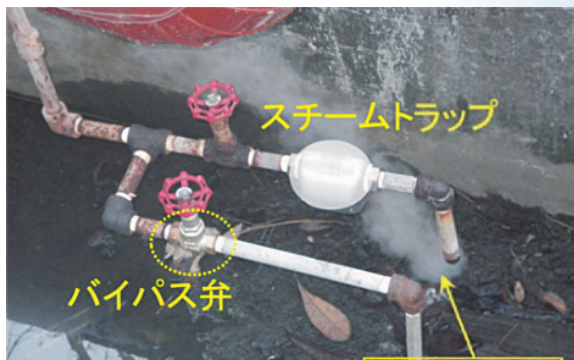
第3図 スチームトラップの故障(弁故障により常時蒸気が漏洩)
