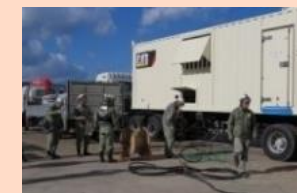
電源車操作訓練
