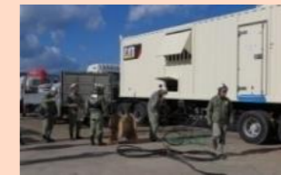
電源車操作訓練
