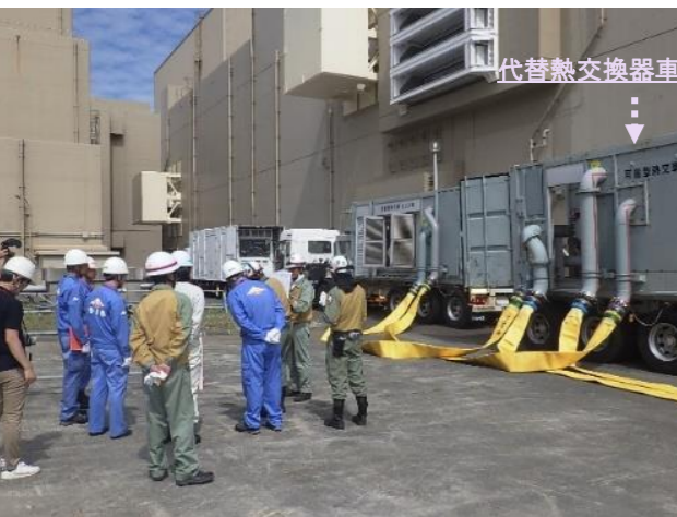
代替熱交換器用配管設置工事及び可搬設備の確保（代替熱交換器車）点検の様子【第87回（9月10日）】
