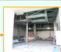
ガスタービン建屋の内部
