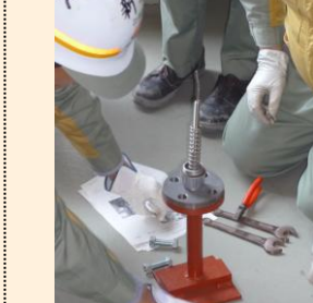
原子炉建屋内のタンク接続口の構造確認および取扱訓練
