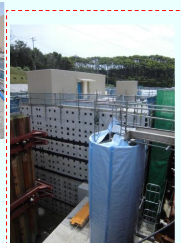
●ポンプ室現場
