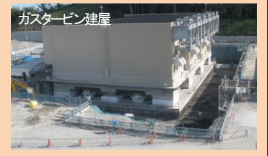
ガスタービン発電機
