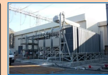
・受電用変圧器を高台25mに設置
