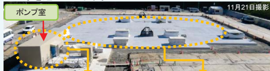
11月21日撮影 ポンプ室
