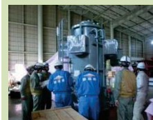
緊急時資機材倉庫保管の海水取水ポンプ予備品点検の様子(11/7)
