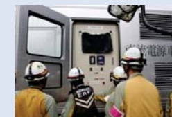
④直流電源装置を起動している様子
