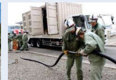
電源車へのケーブル接続訓練
