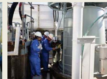
海水ポンプ軸受注水の無注水起動対策点検の様子
