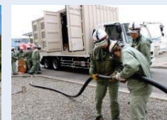
電源車へのケーブル接続訓練
