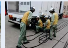
電源車へのケーブル接続訓練
