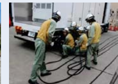
電源車へのケーブル接続訓練
