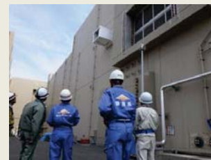
建屋開口部への自動閉止装置点検の様子
