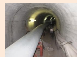
排気連絡ダクト（地下）
