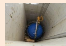
フィルタベント容器 (H27.3設置)
