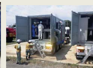
可搬型備の確保点検の様子
