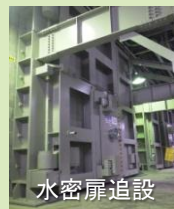
水密扉追設 内部溢水対策
