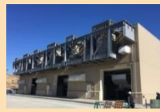
⑤ガスタービン発電機
