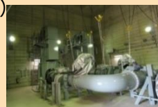
①緊急時海水取水設備
