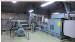
ポンプ室内部
