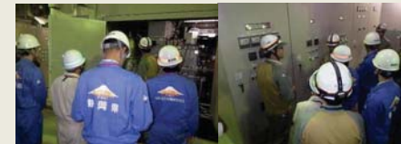
ガスタービン発電機の高台設置 点検の様子
