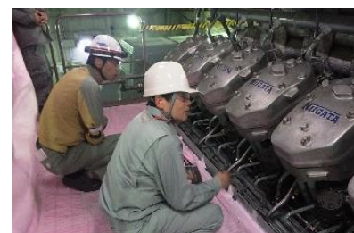
非常用ディーゼル発電機の作動試験確認の様子
