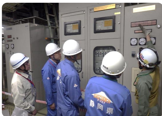
高圧炉心スプレイ系蓄電池容量の増強工事の確認の様子
