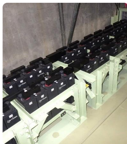
高圧炉心スプレイ系蓄電池
